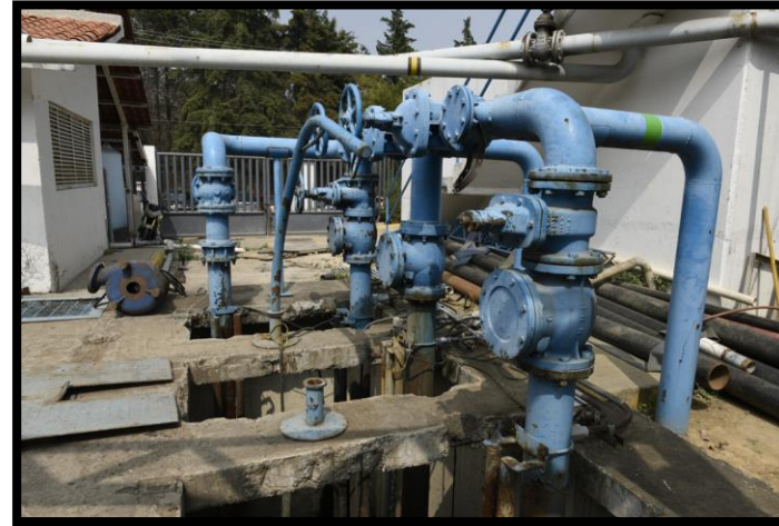
Cambio de válvulas de control y regulación de presión en redes hidráulicas
